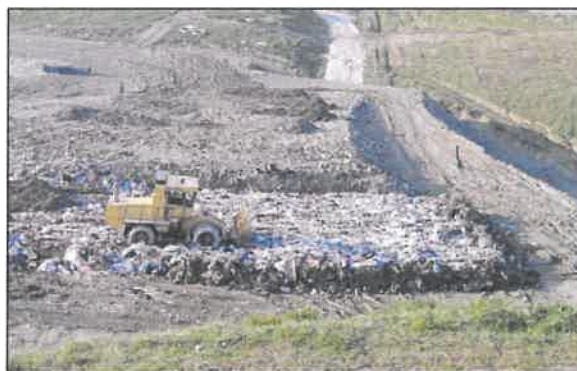
Abbancamento rifiuti nelle apposite celle
