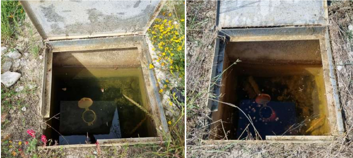
Figura 3 – Confronto tra foto del 20-5 e foto del 19-9-2025 del pozzetto di un piezometro Casagrande
