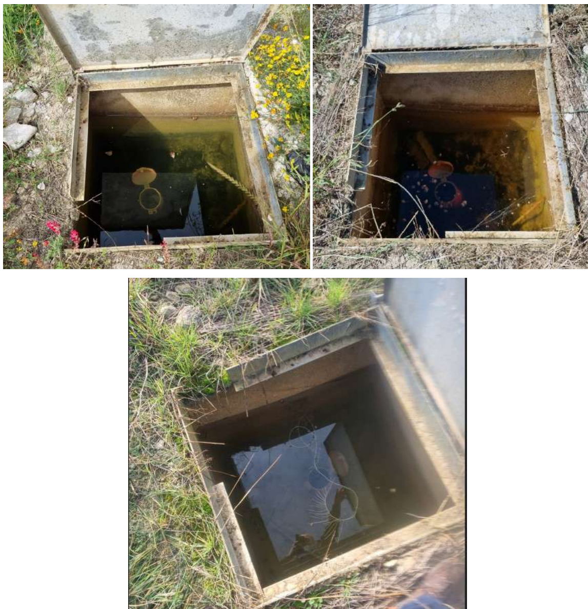
Figura 3 – Confronto delle foto del 20-5, 19-9 e del 23-1-2026 del pozzetto di un piezometro Casagrande
