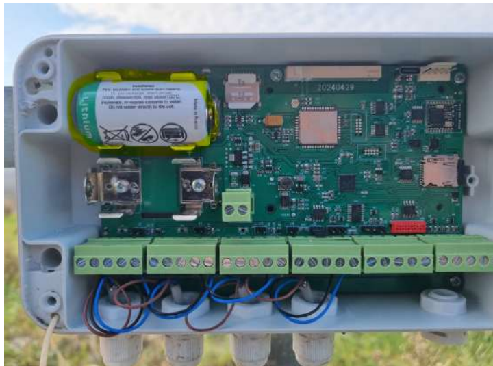
Figura 5 – Foto della centralina di acquisizione dei dati dell'estensimetro 2 con evidenza della batteria
