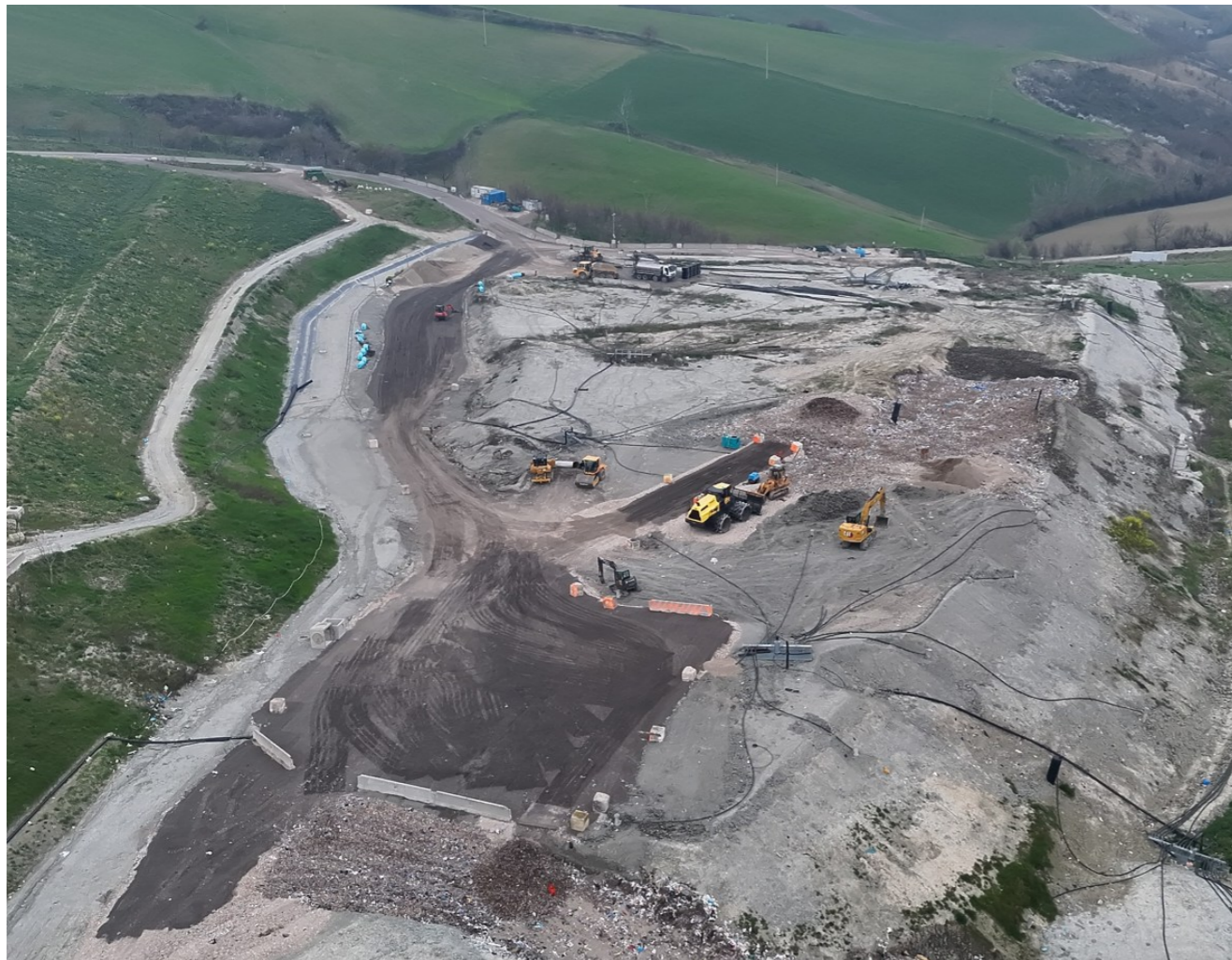
Particolare zona scarico "ALTRI"
