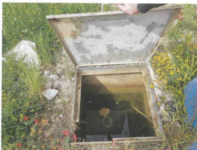
Figura 3 – Fotografia del pozzetto di un piezometro Casagrande presa il 20-5-2025
